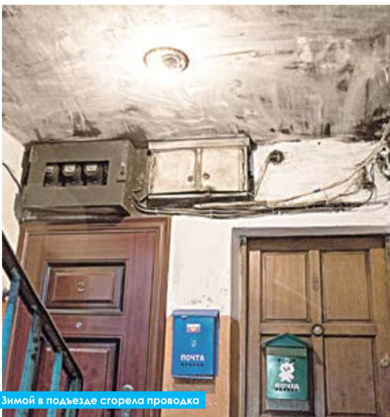
Осторожно, высокое напряжение!
